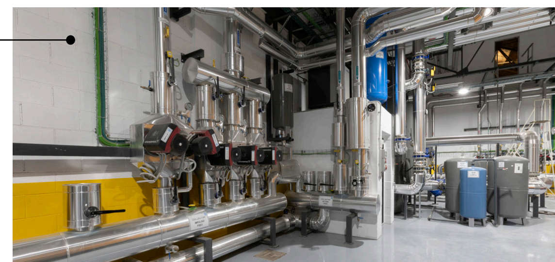
TECHNOTRAF Instalación de autoconsumo con calderas de biomasa y refredadora de absorción St. Vicenç de Torelló, Barcelona Superficie construida: 9.500 m 2
